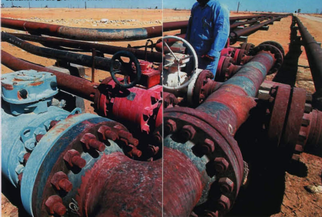
ÖL-PIPELINES im Oman. Im Nahen Osten schlummern die größten Rohstoff-Reserven
